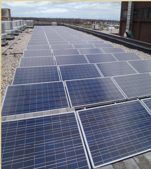
24 kW PV Array
