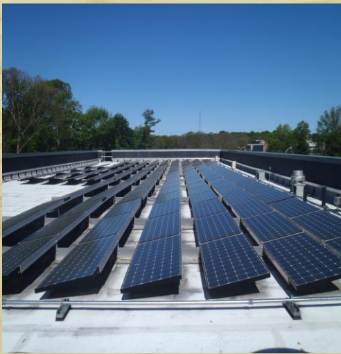
60 kW PV Array
